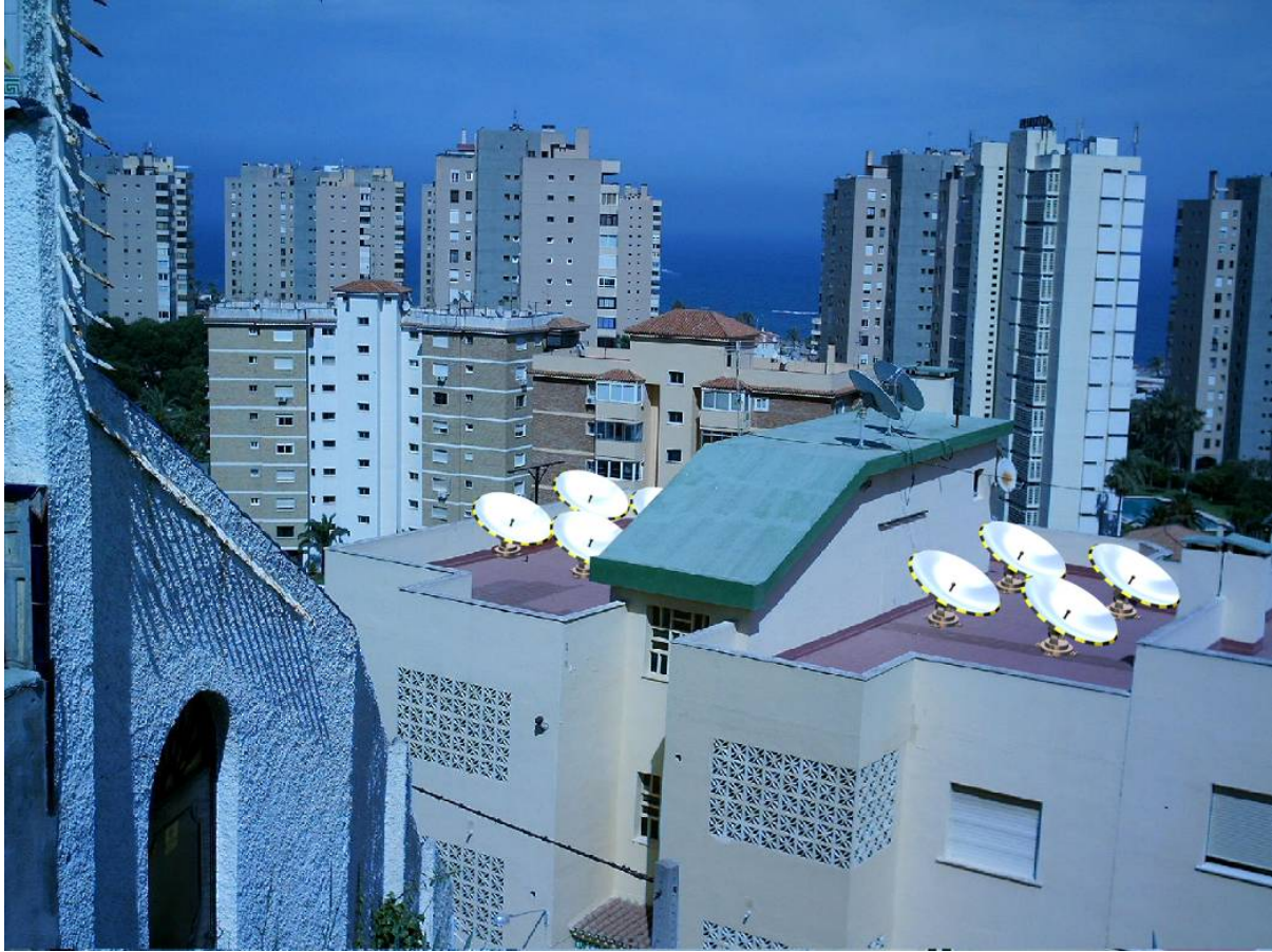
Fotografía 1.1. Instalación Solar Termovoltáica en Comunidad de Propietarios
