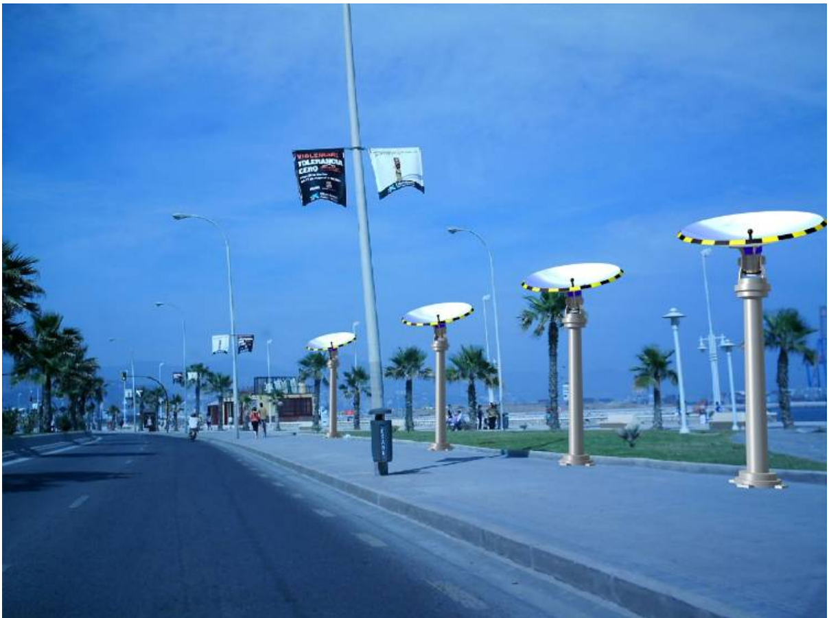
Fotografía 1.2. Instalación Solar Termovoltáica en espacio urbano
